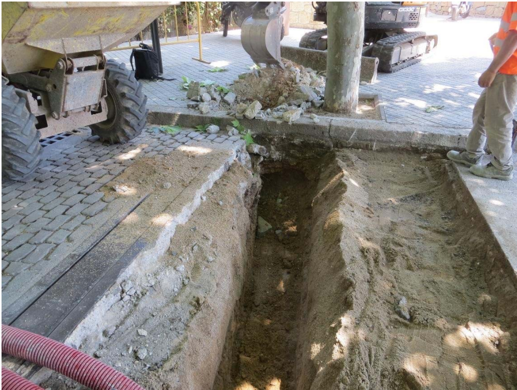
Fig. 13: Rasa 1 en creuar el carrer del Cementiri. Es pot observar el nivell saulonós UE 119. A l'esquerra es pot observar el paviment anterior de rajols, documentat en diversos punts del seguiment.
